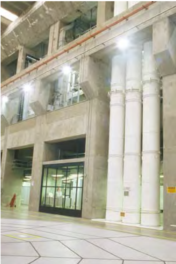
Foto 43 Piso do gerador, galeria elétrica.
